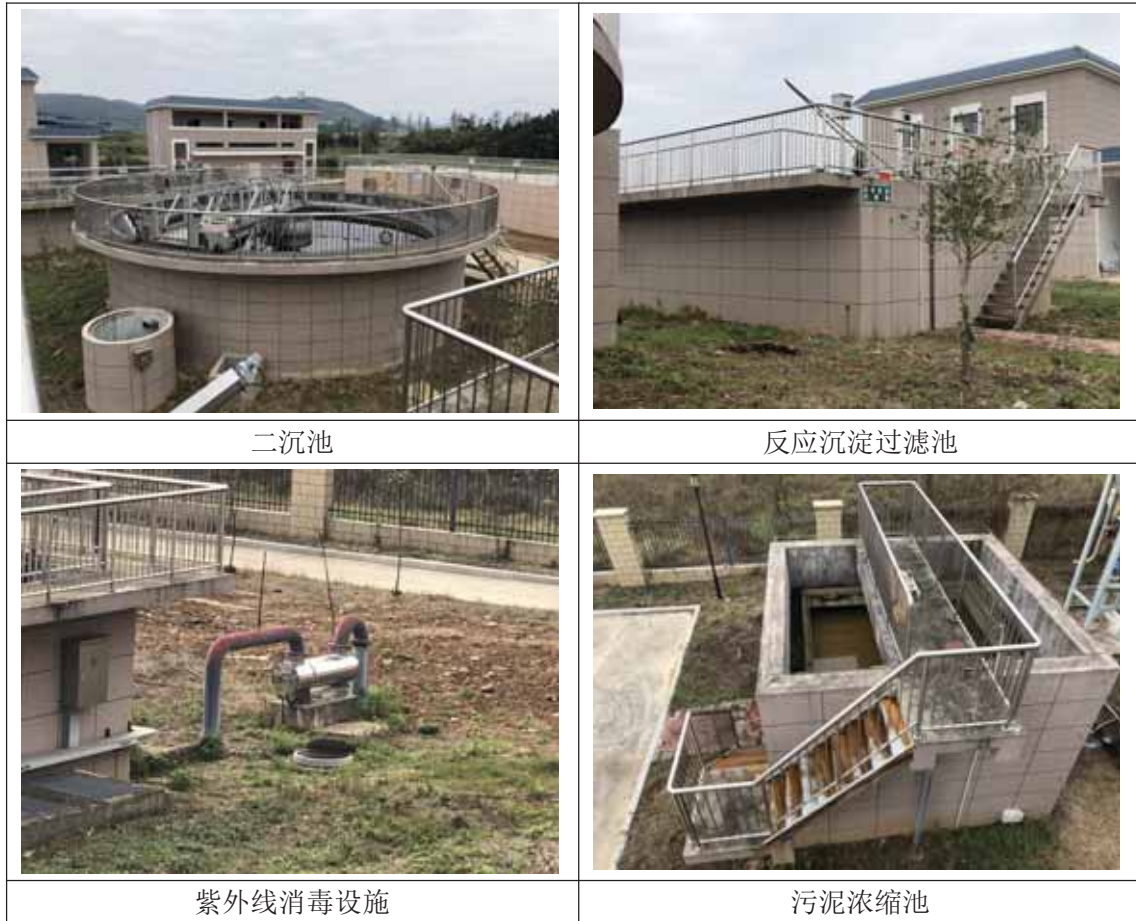
图 4.1-1 废水治理设施图
